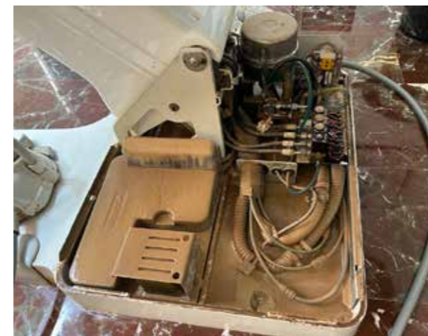
Schlamm geht durch jede Ritze, dieser Fuß konnte allerdings repariert werden.
